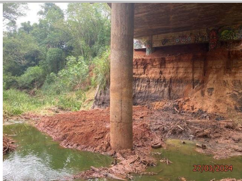
Foto 10 - Km 141+180 – Vista da erosão, aterro com ângulo de 90° na área do encontro e carreamento de solo para o curso d'água.
