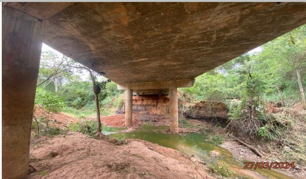
Foto 8 - Km 144+180 – Vista inferior da OAE e deflagração de Processos Erosivos em área contígua ao encontro.
