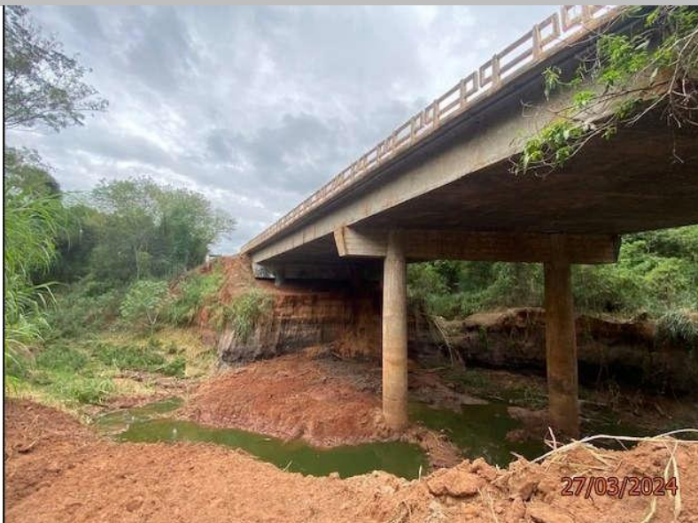
Foto 9 - Km 144+180 – Lateral da OAE e deflagração de Processos Erosivos em área contígua ao encontro e solapamento das margens do Córrego Galante.
