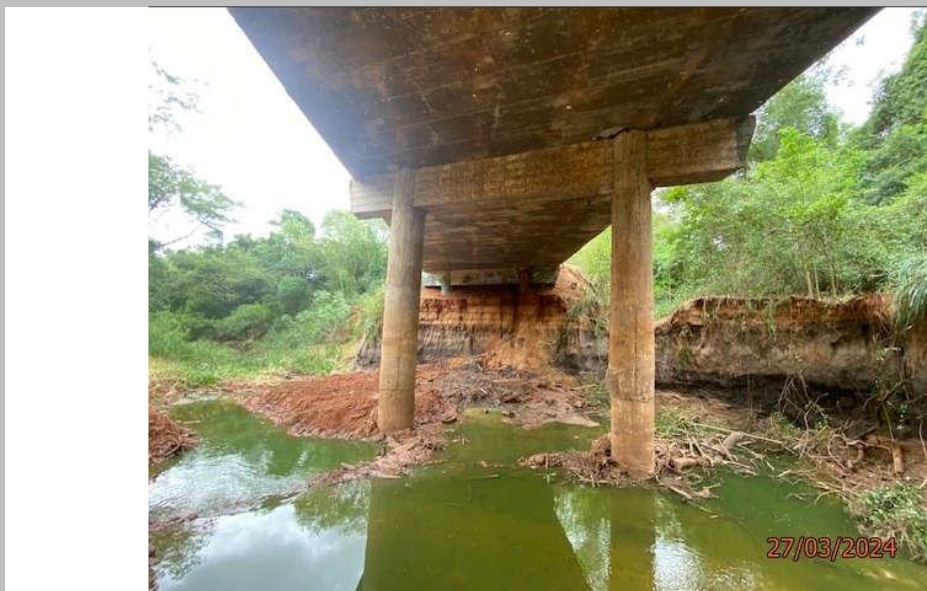
Foto 11 - Km 141+180 – Vista Geral da Laje da Ponte, Apoios Centrais e deflagração de processo erosivos no Encontro e solapamento das margens do Ribeirão Galante.
